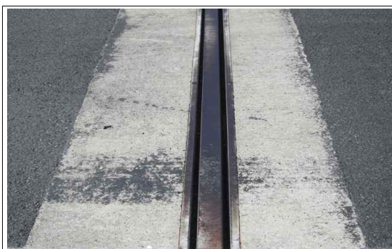
신축이음 상행선 A1 후타재 균열
