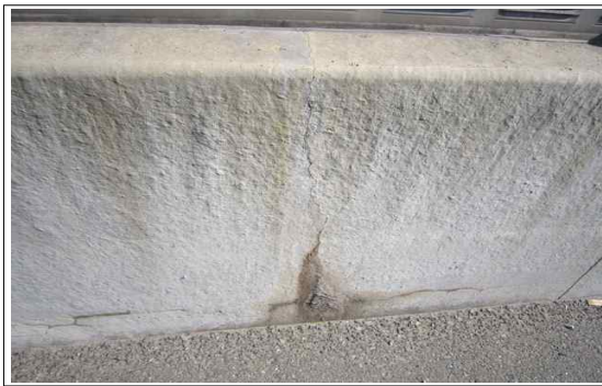
방호벽 상행선 S4 균열 및 백태
