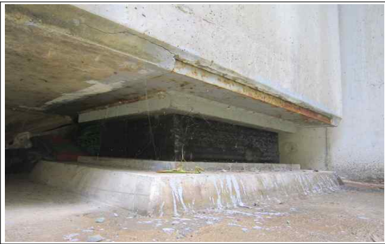
교량받침 하행선 A1-SH1 PLATE 녹발생
