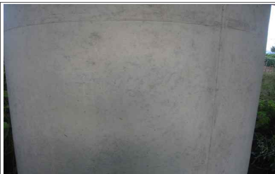
교각 상행선 P2 좌측 기둥부 균열
