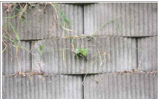
옹벽 시점부 균열 CW=0.2
