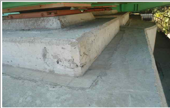
교량반침 상행선 P1-SH4 반침콘크리트 재료분리
