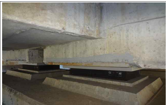
교량받침 상행선 P1-SH09 받침 들뜸
