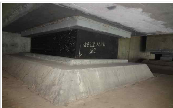
교량반침 상행선 A2-SH2 탄성받침 들뜸
