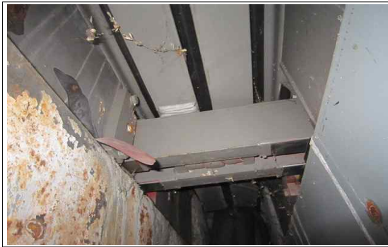
신축이음 하행선 A1 하부 유간조절장치 이탈 및 탈락
