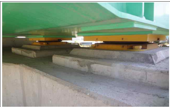
교량받침 하행선 P4-SH1 받침콘크리트 균열
