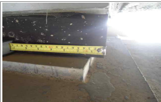
교량받침 상행선 P6-SH04 이탈
