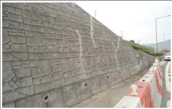
하행선 옹벽 시점부 균열 (폭 0.2mm)
