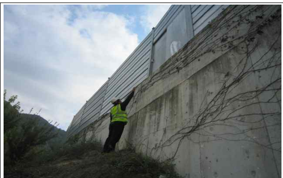
교대 상행선 A1 측면 점검계단 필요
