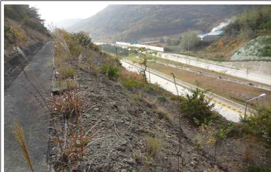
사면(시점부-우측) STA.0+ 120 1단 이완암
