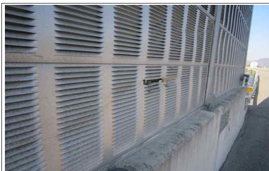
방호벽 하행선 A2 접속부 방음벽 파손
