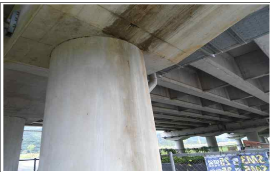
교각 하행선 P9 기둥부 표면균열
