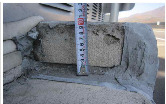
방호벽 하행선 S1 접속부 방호벽 단차
