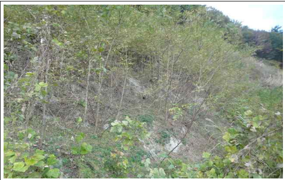
사면(시점부) STA.0+60 2단 녹생토탈착
