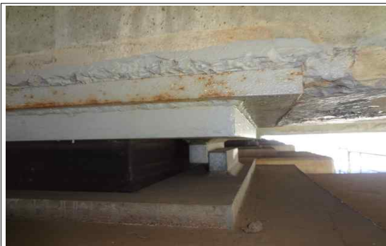
교량받침 하행선 P5-SH05 스톱퍼 간섭
