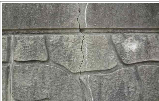
상행선 옹벽 시점부 균열 (폭 0.5mm)
