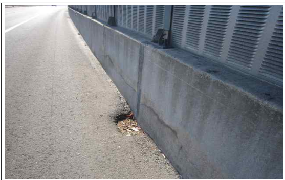
방호벽 하행선 S6 수평균열
