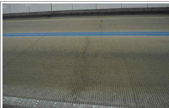
하행선 포장부 S26 균열
