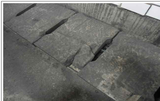
하행선 공동구 S15 덮개 파손
