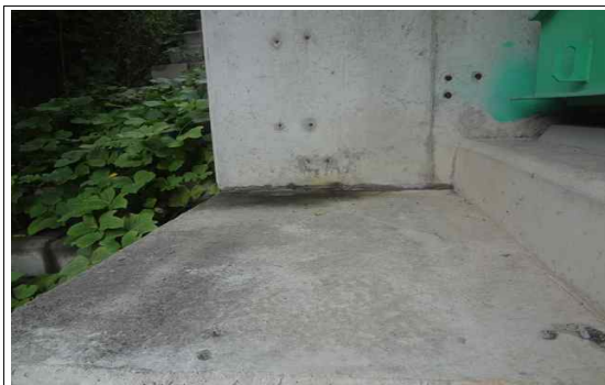
교대 하행선 A2 상면 체수흔적
