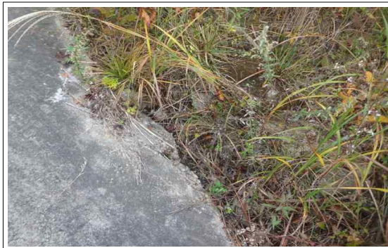
사면(종점부-하행) STA.0+100 1~2단 누수 및 세굴
