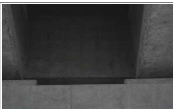
주형 하행선 S5 가로보 하부 들뜸 0.2*1.0
