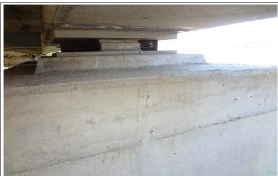
교량받침 상행선 P5-SH05 받침콘크리트 균열
