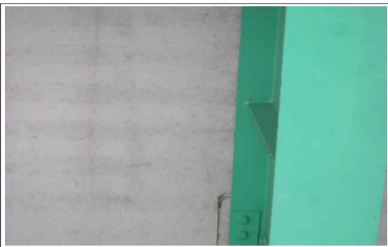
바닥판하면 하행선 S2 균열 0.2
