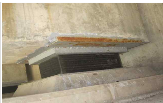
교량받침 하행선 A1-SH1 녹발생
