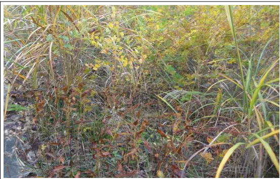
사면(종점부-하행) STA.0+100 3단 표층유실
