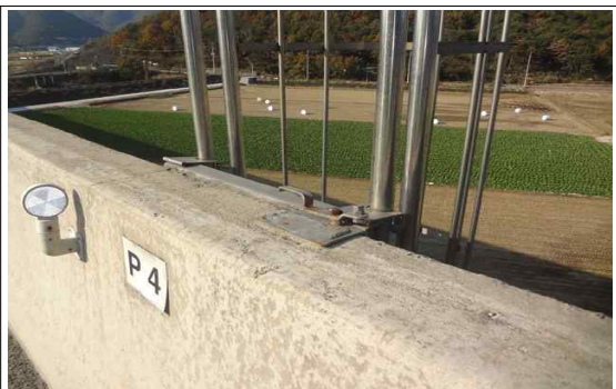
교각 상행선 P5 점검로 시건장치 파손
