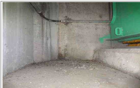
교대 상행선 A2 상면 체수흔적
