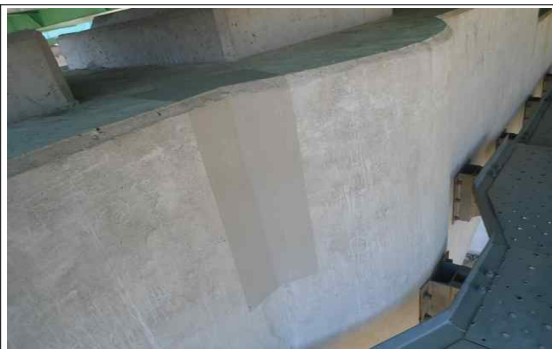
교각 상행선 P6 코핑부 재균열
