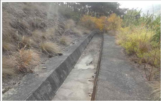
사면(시점부-우측) STA.0+ 50 1소단배수로 체수흔적
