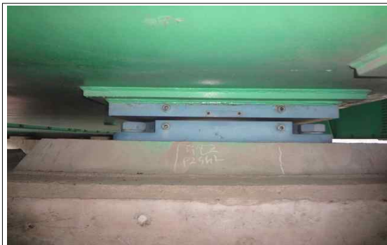
교량받침 상행선 P2-SH2 몰탈 재균열
