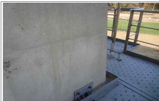
교각 상행선 P5 코핑부 정면 표면균열
