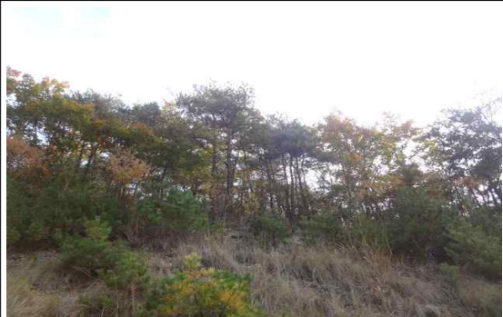
사면(시점부-우측) STA.0+ 70 자연사면 수목전도위험
