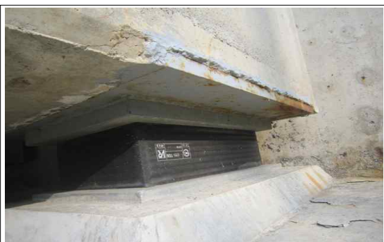
교량반침 상행선 A1-SH1 녹발생
