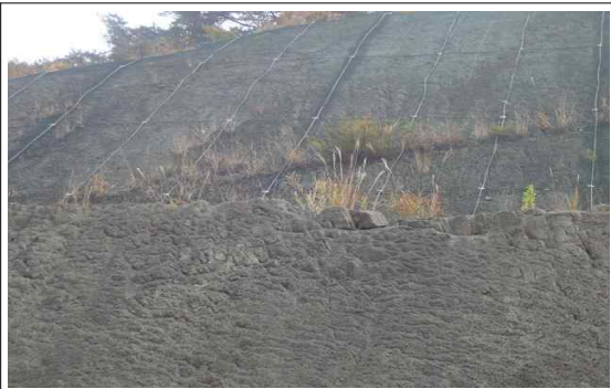
사면(중점부-상행) STA.0+ 40 1단 상부 낙석
