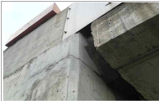
교대 상행선 A1 균열 CW=0.2
