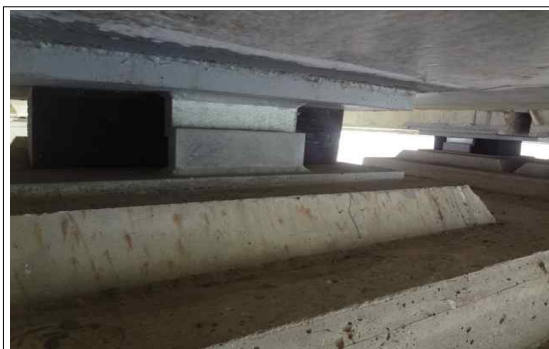
교량받침 상행선 P1-SH6 무수축물탈 균열
