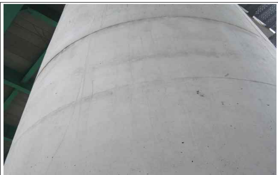
교각 하행선 P7 기둥부 표면균열
