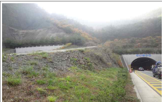
사면(종점부-하행) STA.0+110 1단 뜯돌 및 낙석우려
