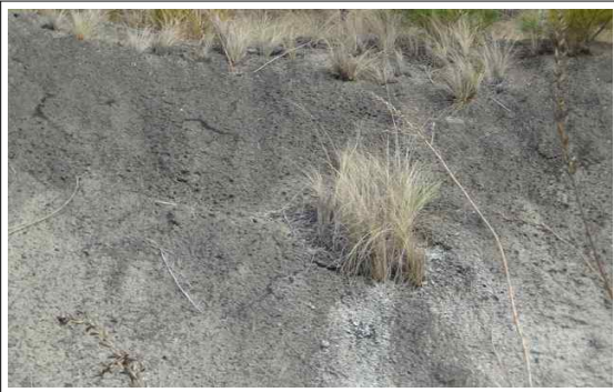
사면(시점부-상행) STA.0+ 170 2단 숏크리트 들뜸
