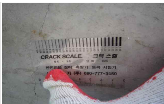
바닥판하면 상행선 S2 우측 균열
