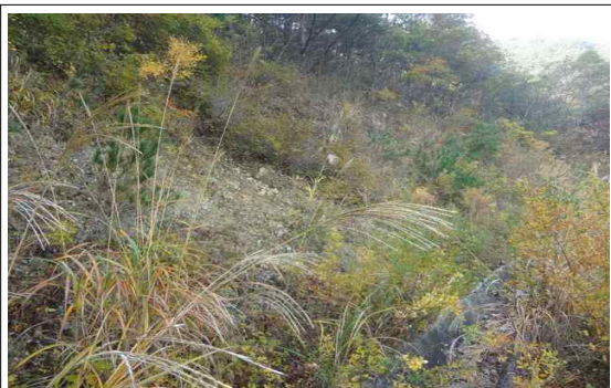
사면(중점부-하행) STA.0+ 70 자연사면 표층유실
