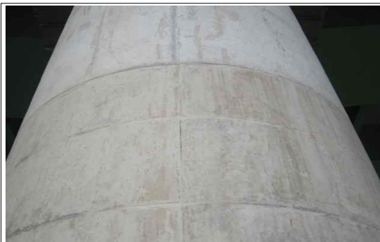
교각 하행선 P5 기둥부 좌측 균열 CW=0.1~0.2
