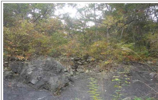
사면(종점부-하행) STA.0+100 자연사면 토석류
