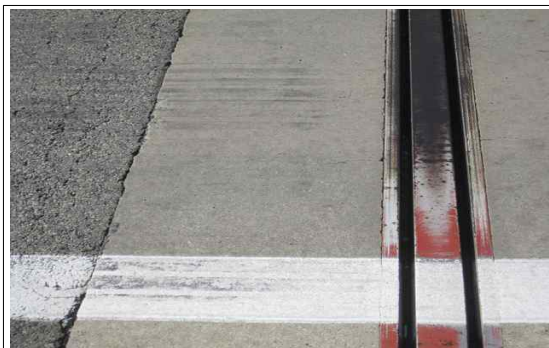
신축이음 상행선 A1 후타재 균열
