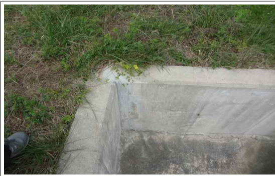
사면(시점부) STA.0+40 갯문배면 배수로 균열
