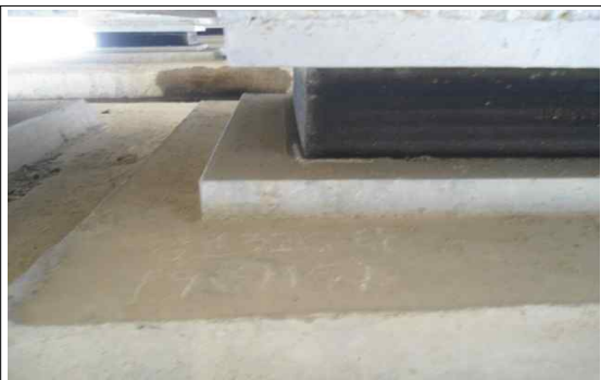
교량받침 하행선 P9-SH05 본체 들뜸
