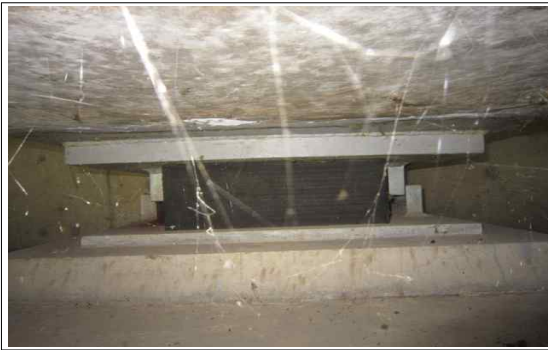
교량받침 상행선 A1-SH3 스토퍼 간섭
