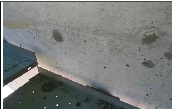
교각 상행선 P7 코핑부 균열
