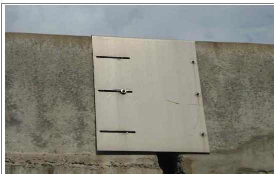
방호벽 하행선 A1 차수판 앵커탈락
