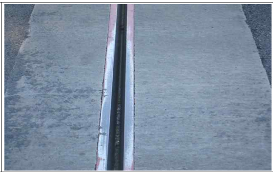
신축이음 하행선 A1 후타재 균열 및 재균열
