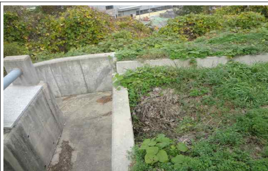
사면(중점부) STA.0+ 150 1단 배수로 배면 뒷채움 유실 및 공동
