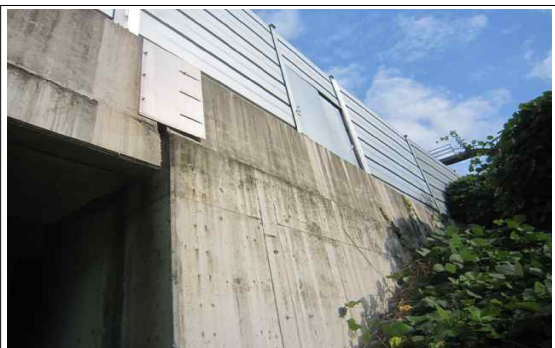
교대 하행선 A1 측면 점검계단 필요
