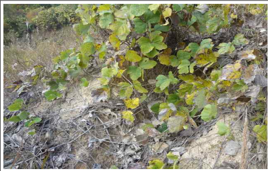
사면(시점부-하행) STA.0+ 20 2단 표층유실 및 세굴
