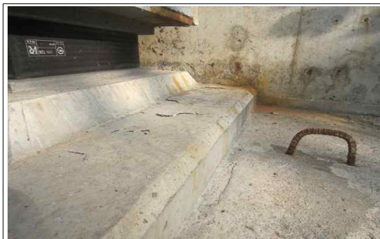
교량반침 상행선 A1-SH1 받침콘크리트들뜸
