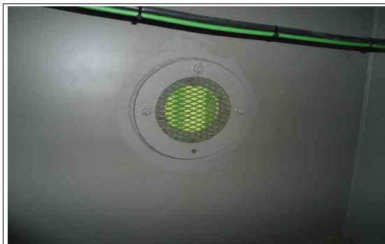
주형내부 하행선 S7-G2 환풍구 볼트 탈락
