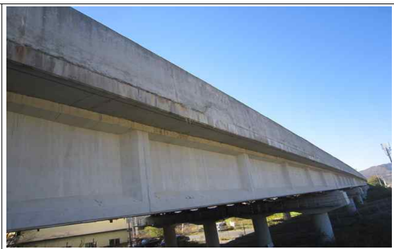
바닥판하면 상행선 S1-A1측 누수 및 백태
