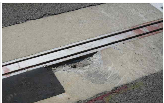
신축이음 상행선 A1 후타재 파손
