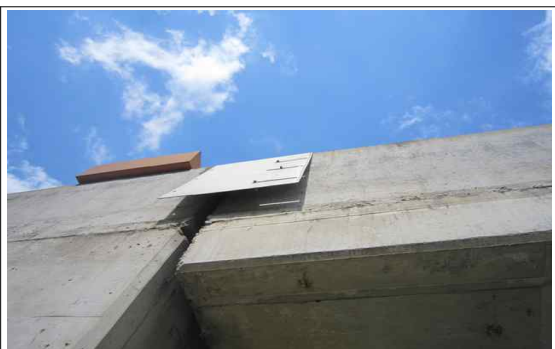
방호벽 하행선 A2 차수판 앵커탈락
