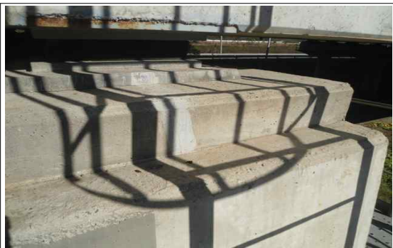
교량받침 하행선 P6-SH01 받침 균열
