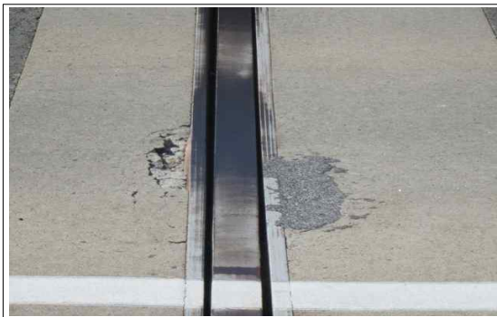
신축이음 상행선 A1 후타재 파손
