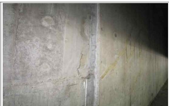
옹벽 시점부 A1 콘크리트 들뜸 A=0.5*0.5
