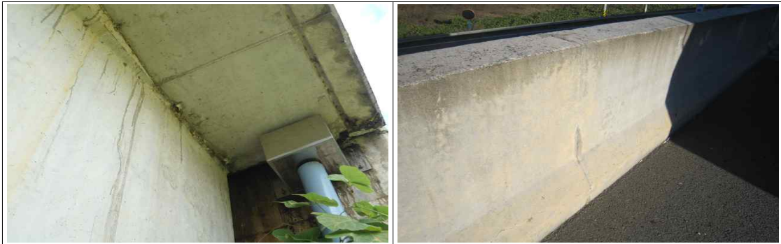
배수시설 상행선 A2 길이부족으로 인한 낙수
