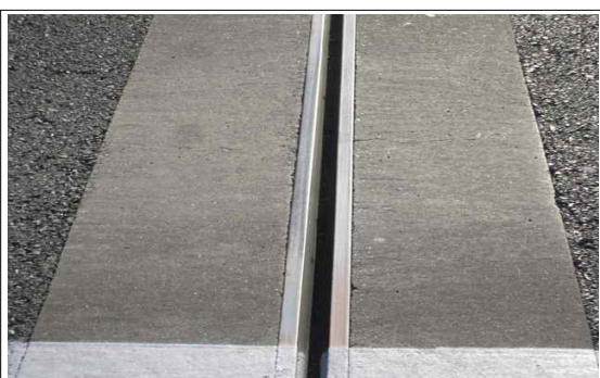
신축이음 상행선 P3 후타재 균열
