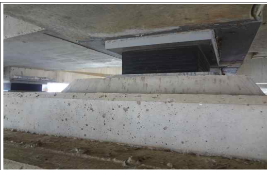
교량받침 상행선 P1-SH09 받침콘크리트 균열
