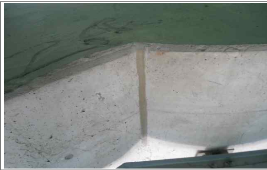
교각 상행선 P1 코핑부 보수부 재균열
