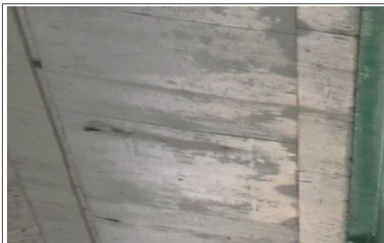
바닥판하면 상행선 S2 좌측 캔틸레버 파손
