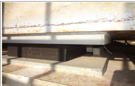
교량받침 상행선 P2-SH05 스토퍼 간섭
