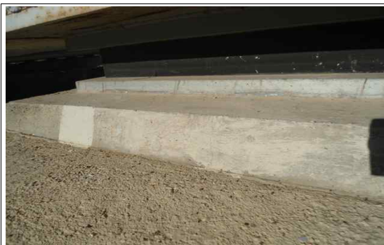
교량받침 하행선 P8-SH01 무수축물탈 균열
