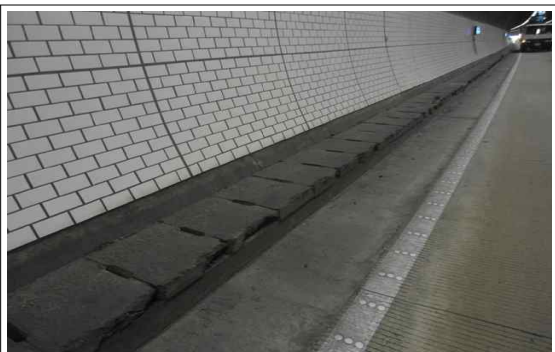
하행선 공동구 S17 덮개 파손 (17EA)
