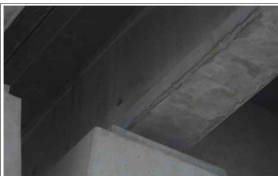
주형 상행선 S5 홀부위 파손 0.1*0.1
