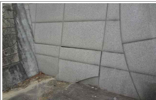
상행선 갯문 종점부 파손 (4EA)
