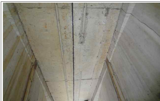
바닥판하면 상행선 S2-P2측 물끊기홈 미제거
