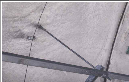
하행선 천정부 S2 균열 (폭 0.3mm)
