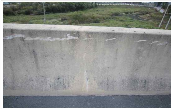
방호벽 하행선 S6 균열
