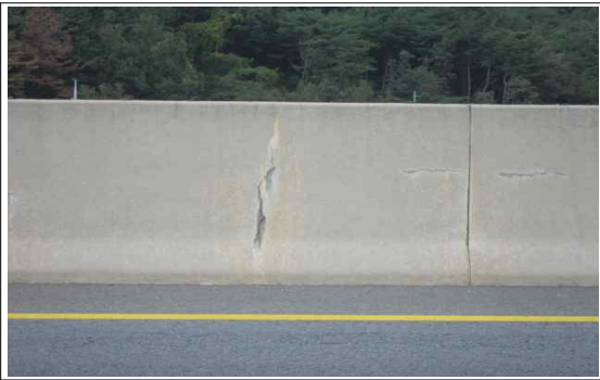
방호벽 하행선 S6 중분대 균열 및 백태
