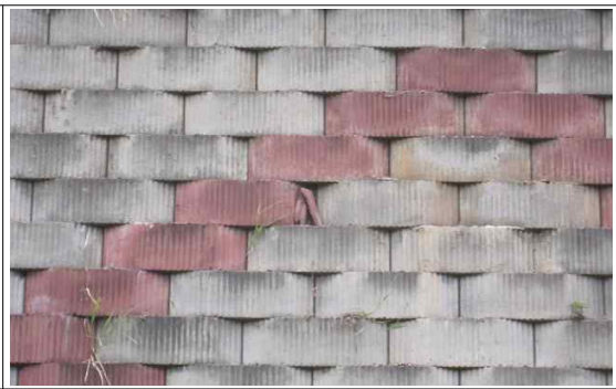
옹벽 시점부 블럭파손
