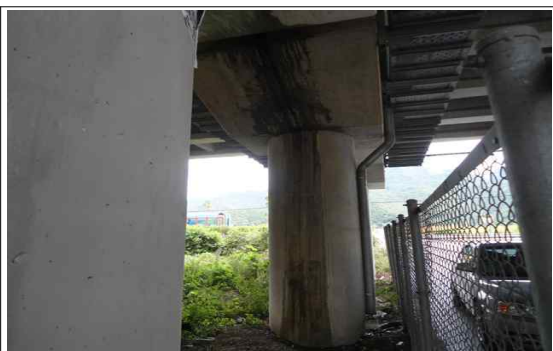
교각 상행선 P9 유도배수관 길이부족으로 인한 누수
