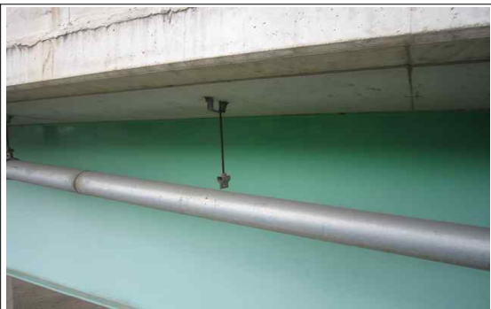
배수관 하행선 S4 고정고리 탈락
