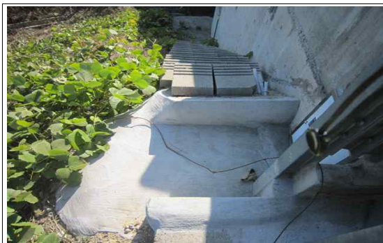
교대 상행선 A2 점검계단 상부 파손
