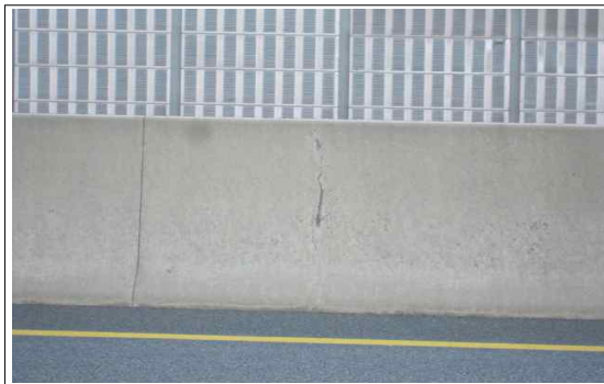
방호벽 상행선 S4 중분대 균열
