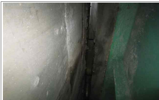
신축이음 상행선 A2 배수흡통 손상
