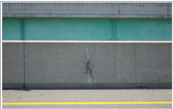
방호벽 상행선 S5 균열 및 백태
