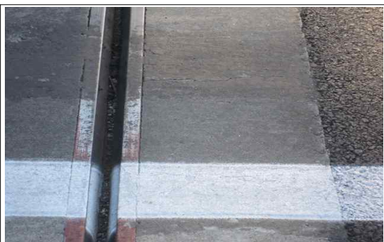
신축이음 상행선 A1 후타재 균열
