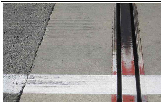
신축이음 상행선 A1 후타재 균열
