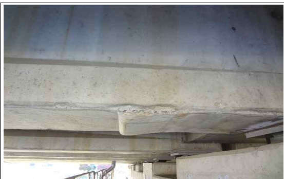
주형 상행선 S2-G4 콘크리트 타설불량
