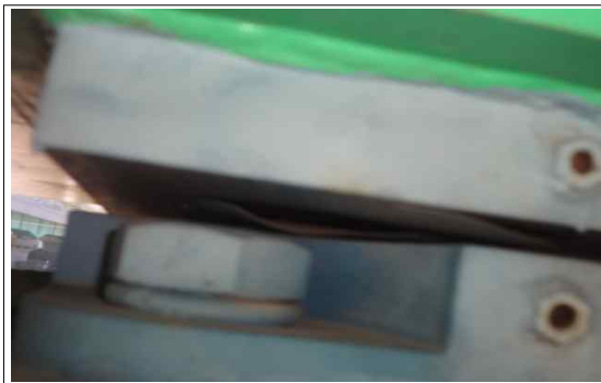
교량받침 하행선 P3-SH3 플레이트 도장 탈락
