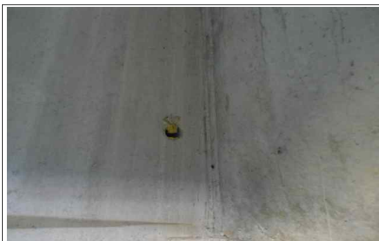
주형 상행선 S8 G4 인양홀 부위 파손
