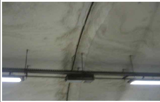
상행선 천정부 J17 콘크리트 들뜸 (A=0.2X0.4)
