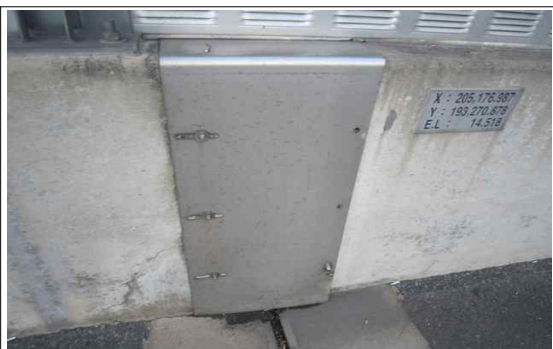
신축이음 하행선 A2 차수판 너트탈락
