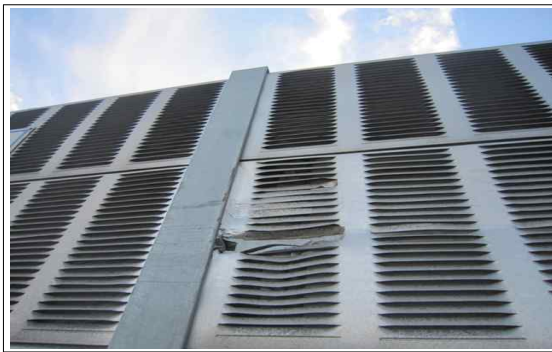
방호벽 하행선 A2 접속부 방음벽 파손
