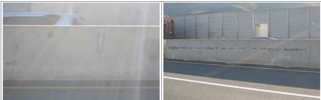
방호벽 상행선 S10 중분대 균열 및 백태
