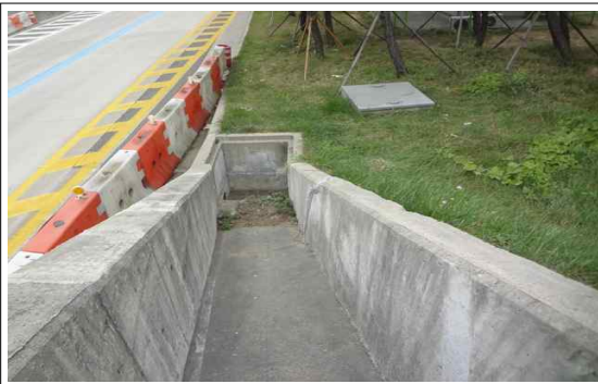
사면(중점부) STA.0+ 120 도수로 파손 보수
