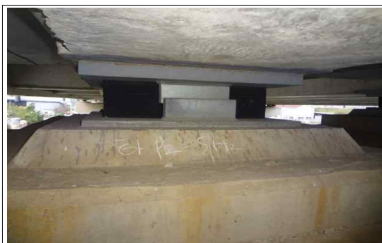
교량받침 하행선 P2-SH2 무수축 물탈 균열
