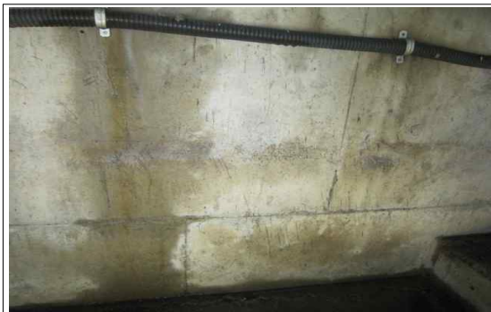
상행선 A2 균열 CW=0.3
