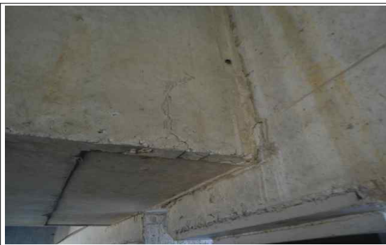
주형 상행선 S7 가로보 들뜸 0.3*0.4
