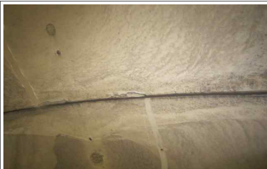
하행선 천정부 J18 콘크리트 들뜸 (A=0.2X0.4)
