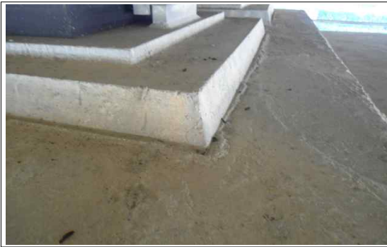
교량받침 상행선 P7-SH03 무수축물탈 들뜸
