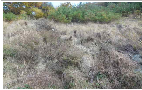
사면(시점부-우측) STA.0+ 150 2단 녹생토유실
