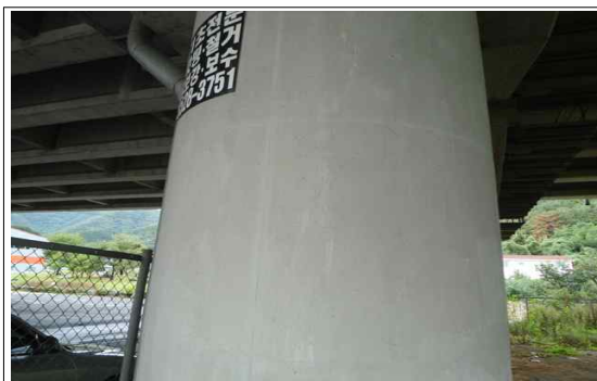
교각 상행선 P9 기둥부 표면균열
