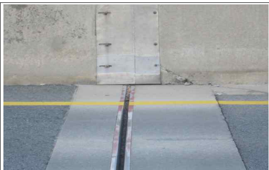
방호벽 하행선 S1 중분대 파손
