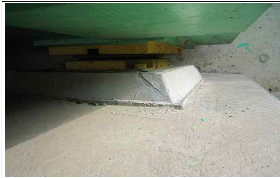
교량반침 상행선 A1-SH1 무수축물탈 들뜸
