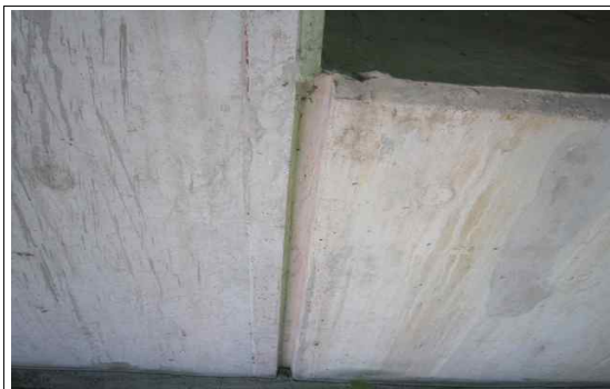
교대 상행선 A1 본체 균열 0.1
