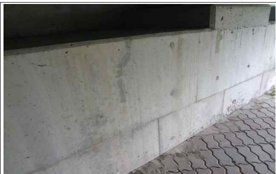
교대 상행선 A2 재균열 CW=0.1
