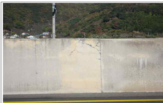
방호벽 하행선 S04 중분대 파손
