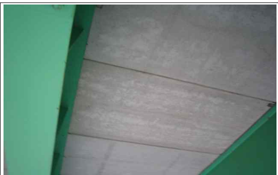
바닥판하면 상행선 S1 덕트 균열 0.2
