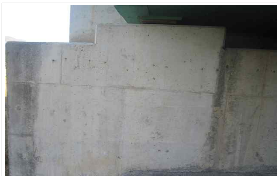
교대 상행선 A1 벽체 누수흔적
