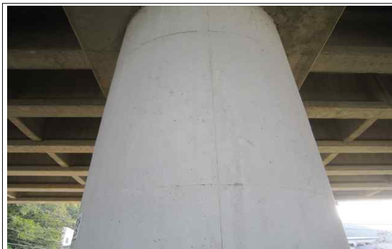
교각 상행선 P1 내면측 좌측 표면균열
