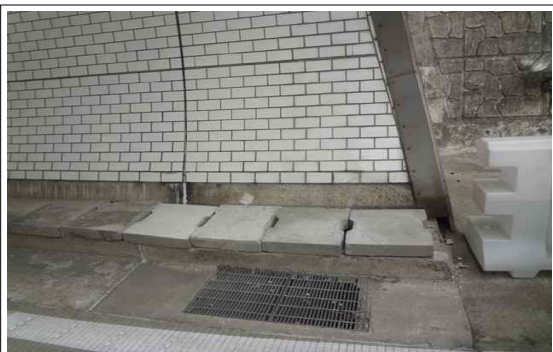
상행선 공동구 S11 덮개 파손 보수
