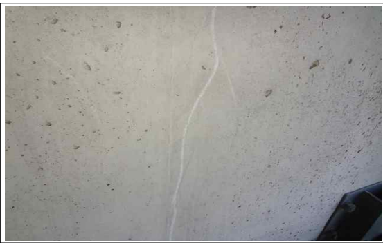
교각 상행선 P4 코핑부 균열 CW=0.2
