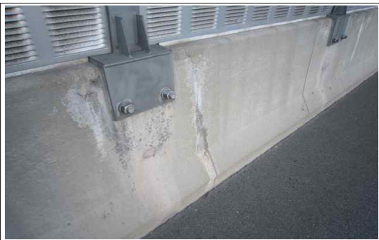
방호벽 상행선 S9 균열 및 백태
