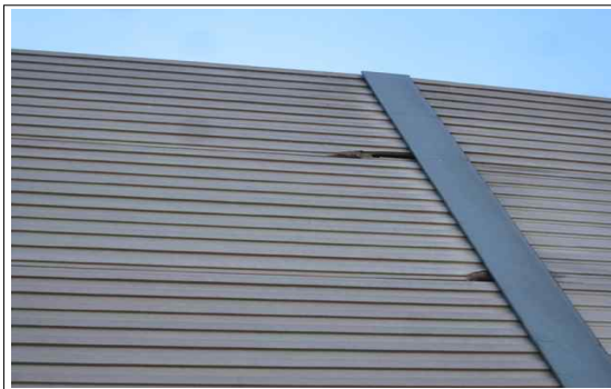
방호벽 하행선 S01 방음벽 파손
