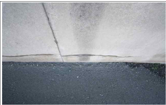
방호벽 하행선 S03 균열
