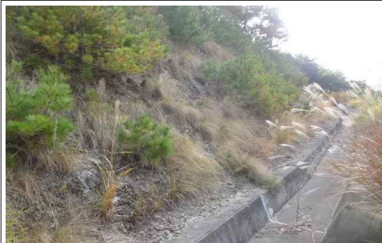
사면(시점부-우측) STA.0+ 60 2단 풍화심함
