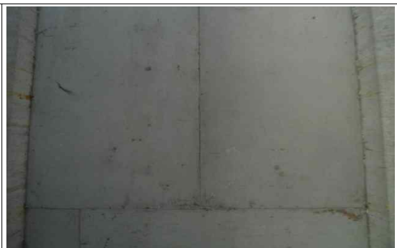
바닥판하면 상행선 S8 표면균열
