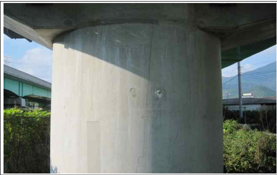
교각 상행선 P1 정면 기둥부 백태
