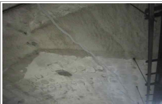
상행선 천정부 S22 재균열 (폭 0.3mm)
