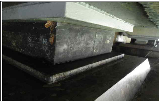
교량받침 상행선 A2-SH2 탄성받침들뜸
