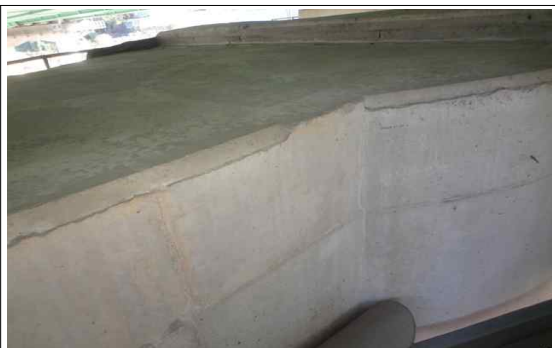
교각 상행선 P6 코핑부 배면 재균열
