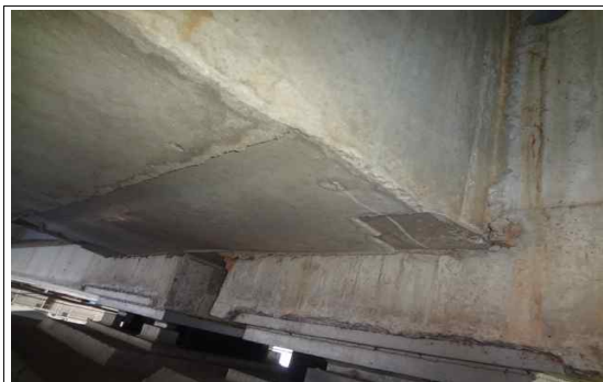
가로보 상행선 S3-G3~4 균열 CW=0.2
