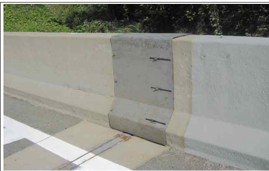
신축이음 상행선 A1 차수판 볼트탈락
