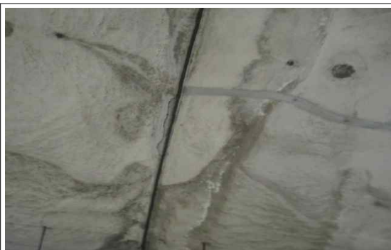
상행선 천정부 J35 콘크리트 들뜸 (A=0.1X0.5)
