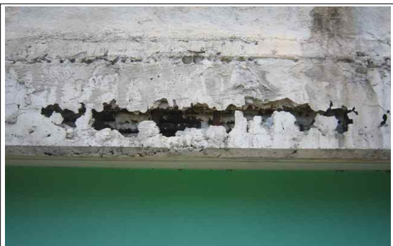
바닥판하면 상행선 S5 우측 캔틸레버 재료분리 0.3*5.0 및 철근노출
