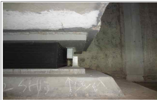
교량받침 상행선 A2-SH3 스토퍼 간섭
