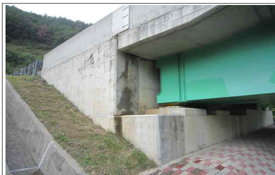
교대 상행선 A2 누수흔적
