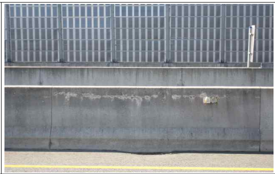
방호벽 상행선 S6 중분대 수평균열
