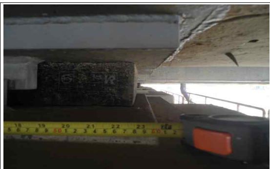
교량받침 상행선 P6-SH08 밀림
