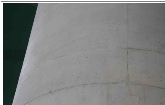
교각 상행선 P3 균열 CW=0.1
