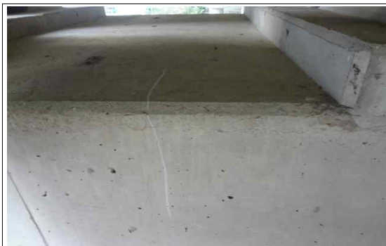
교각 하행선 P6 코핑부 정면 균열 CW=0.2
