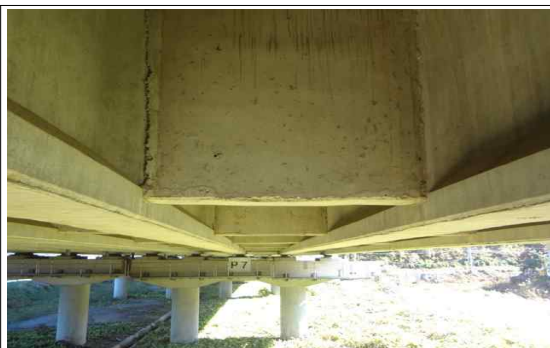
가로보 하행선 S05-G2~3 파손
