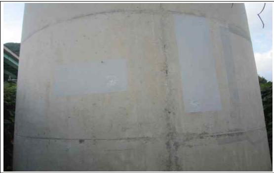
교각 상행선 P5 기둥부 균열
