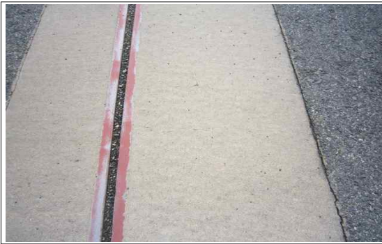
신축이음 A1 후타재 균열
