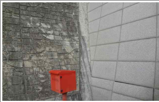
상행선 옹벽 종점부 누수흔적
