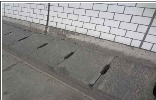
하행선 공동구 S60 덮개 파손 (1EA)
