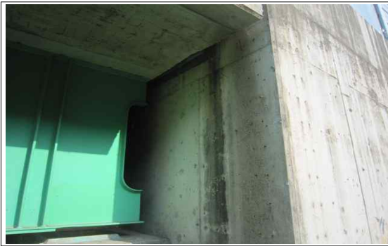
교대 하행선 A1 홍벽 누수흔적
