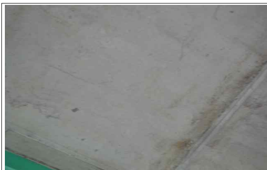
바닥판하면 상행선 S2 우측 균열 다수
