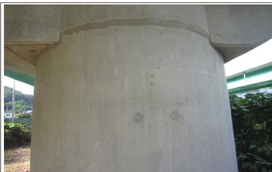
교각 하행선 P1 정면 기둥부 표면균열
