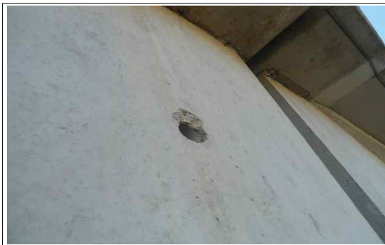
주형 상행선 S6 G5 홀부위 파손 0.1*0.1
