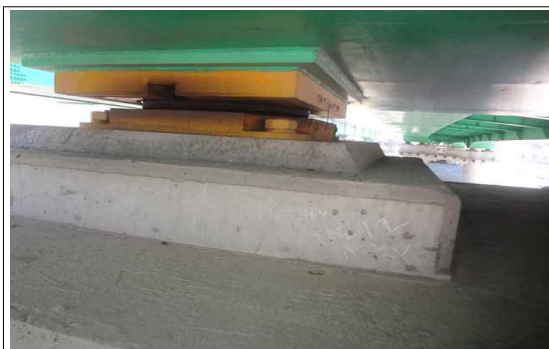
교량받침 하행선 P6-SH4 받침 콘크리트 균열
