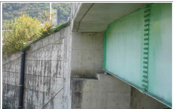
교대 상행선 A1 유도배수관으로 인한 체수흔적
