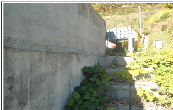
교대 상행선 A2 점검계단 침하
