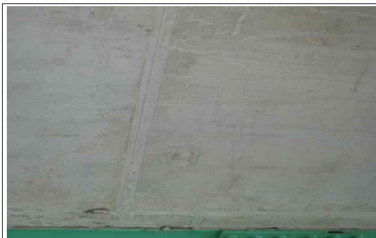
바닥판하면 상행선 S4 우측 균열 다수
