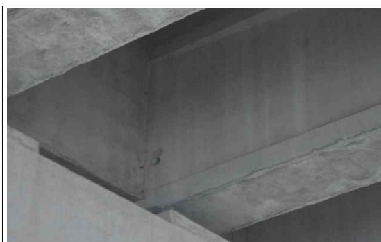
주형 하행선 S4 G5 홀부위 파손
