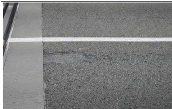
신축이음 하행선 P4 접속도로 파손
