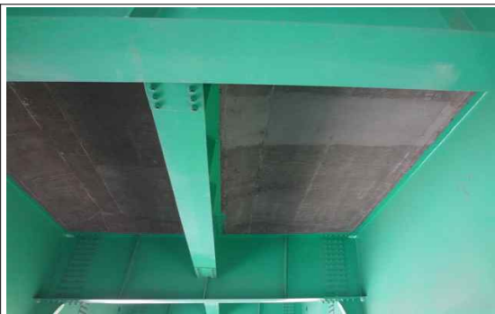
바닥판하면 하행선 S6 P5측 재료분리
