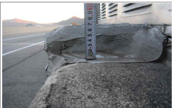
방호벽 하행선 A2 접속부 침하
