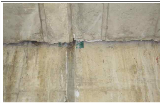
바닥판하면 상행선 S11-A2측 파손
