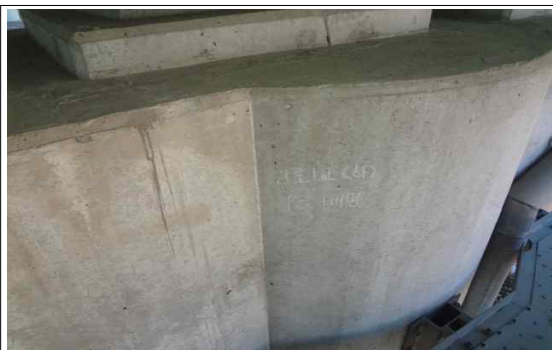
교각 하행선 P3 코핑부 배면 균열
