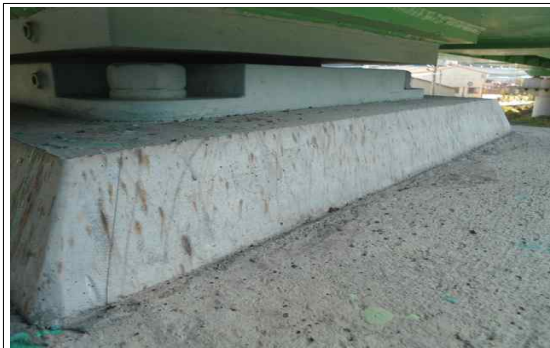
교량반침 상행선 P3-SH1 무수축물탈 균열
