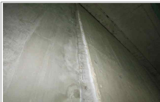
옹벽 시점부 A1 실란트 파손
