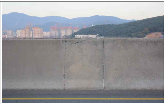
방호벽 하행선 A2 중분대 파손
