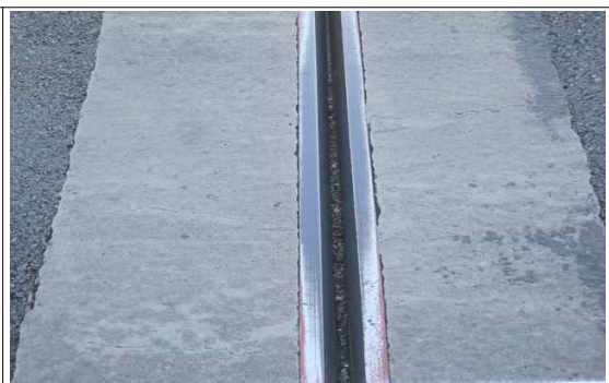
신축이음 하행선 P6 후타재 재균열
