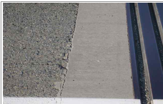
신축이음 하행선 P4 후타재 균열
