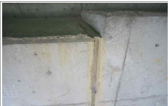
교대 상행선 A1 균열 CW=0.2
