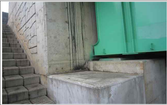
교대 상행선 A1 상면 체수흔적
