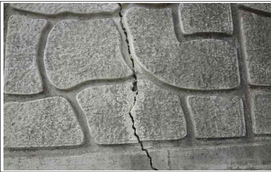
교대 하행선 A2 옹벽부 균열
