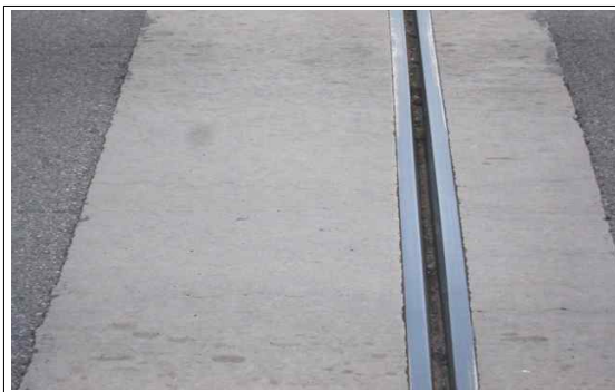
신축이음 하행선 A2 후타재 균열
