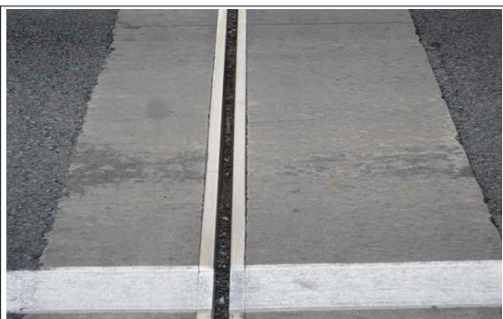
신축이음 상행선 A2 후타재 균열
