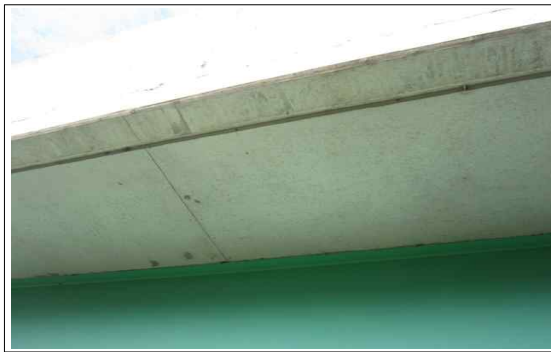
바닥판하면 하행선 S2 좌측 캔틸레버 균열
