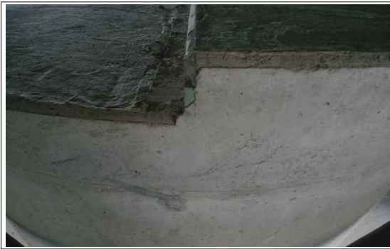
교각 하행선 P1 코핑부 재균열 CW=0.2
