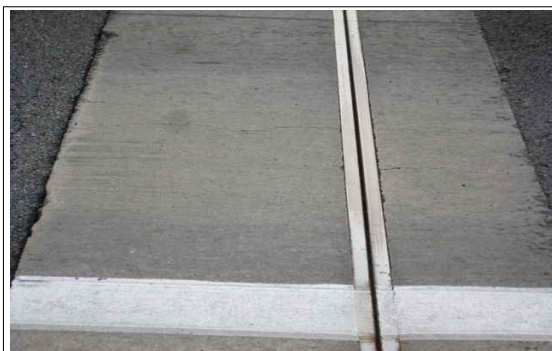
신축이음 상행선 A1 후타재 균열
