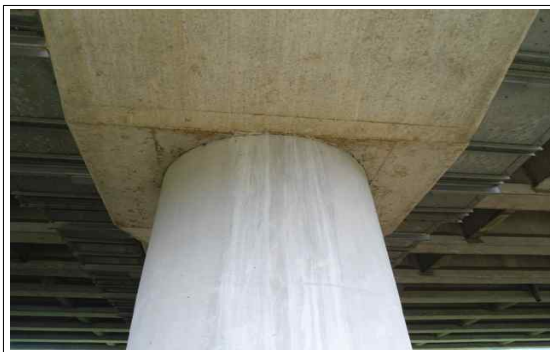
교각 하행선 P10 누수오염
