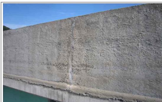
방호벽 하행선 S4 외측 균열부 백태
