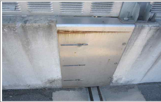
신축이음 하행선 A2 차수판 볼트탈락
