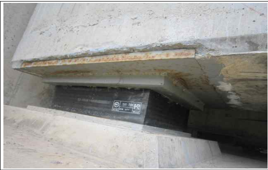
교량받침 상행선 A1-SH5 PLATE 녹발생
