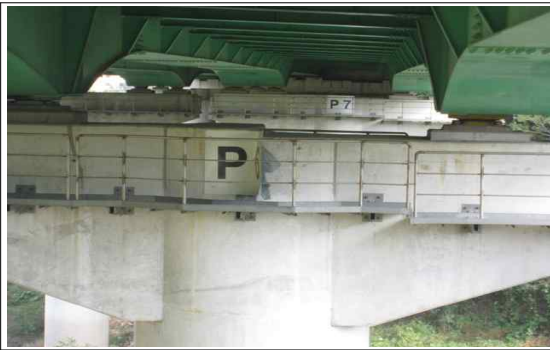
교각 하행선 P2 교각번호판 손상
