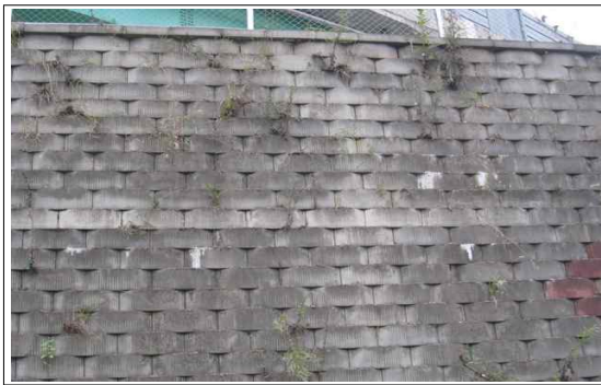
옹벽 시점부 백태 A=0.2*0.2
